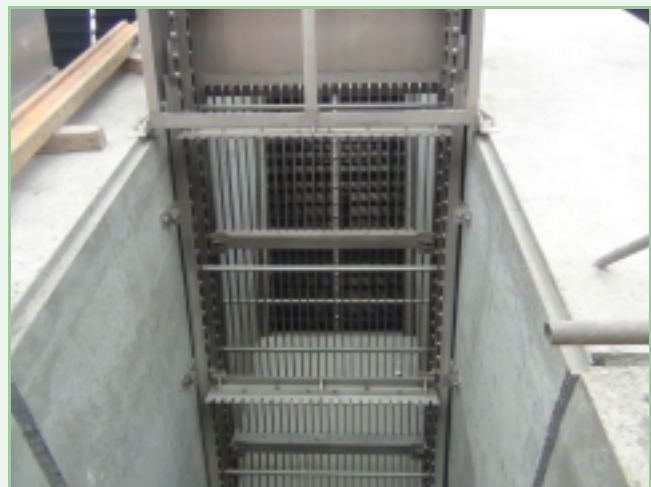
Limpiarreas automático ER instalado en canal.
