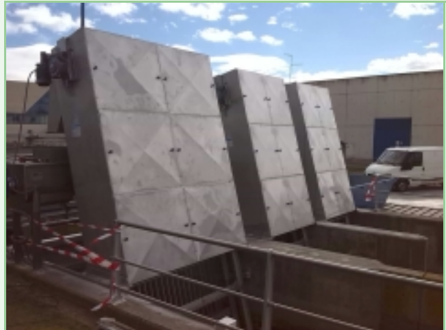
Tres limpiarreas automáticos ER en paralelo.
